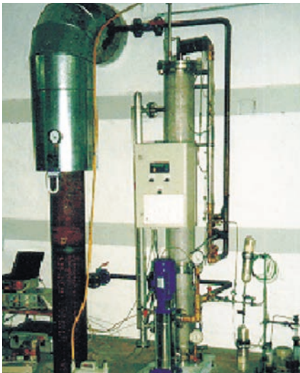
Рисунок 1: система испытания Servitec в тепловой подстанции энергетической компании г. Галле Тепловая мощность: 14,8 МВт Объем воды: приблизительно 100 м 3 Температура среды обратной линии: ≤ 70 °С Давление в обратном трубопроводе: приблизительно 6 бар
